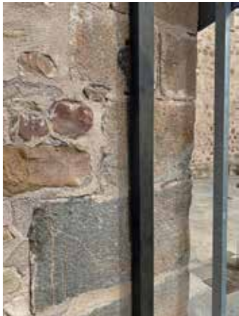
Detall del bastó i la seua situació en l'actualitat. Una llastima que a l'instal·lar la canal quedara quasi tapat.
